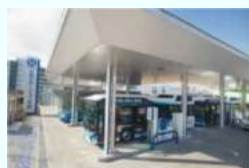
化石燃料由来 水素ステーション
