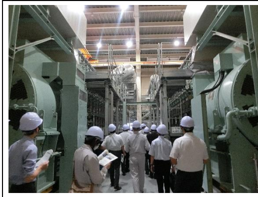
ガスエンジン発電施設
